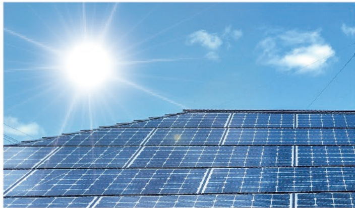
6.3kWの「太陽光発電システム」搭載！
